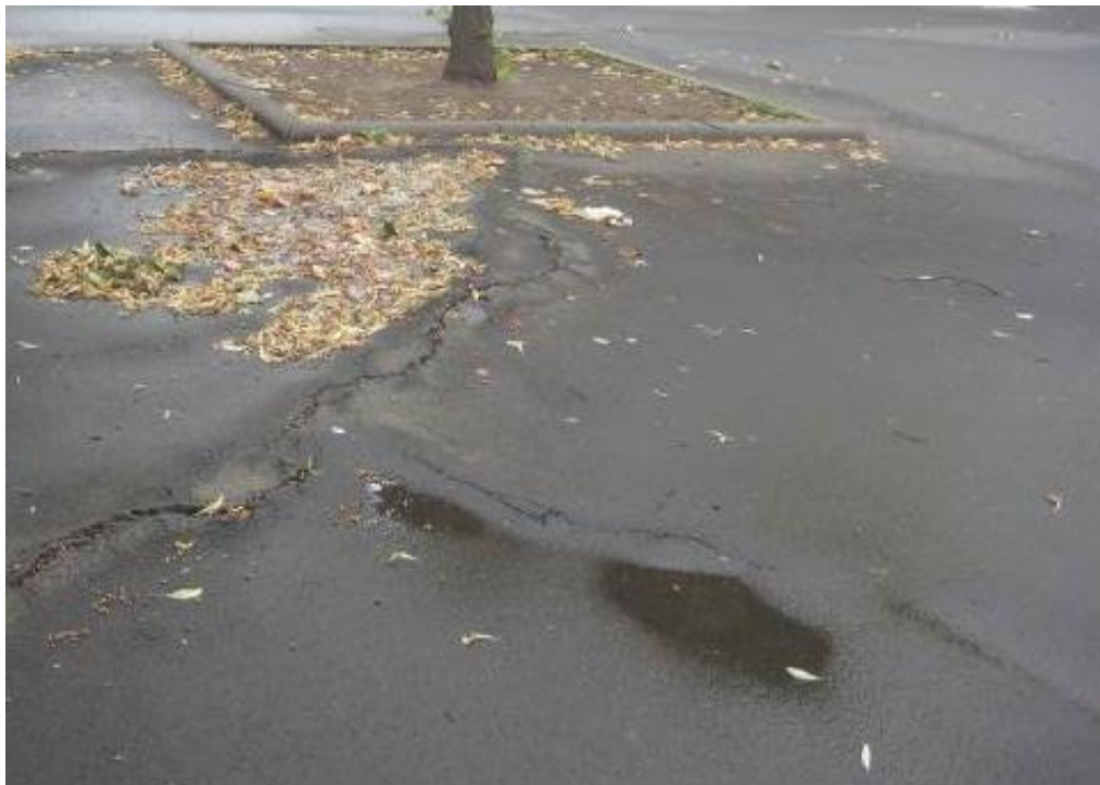
Ansicht 141: Aufgebrochene Asphaltfläche im Schulhof. Karl-Rehbein-Schule. Hanau. Aufnahme vom 17. Juli 2012.
