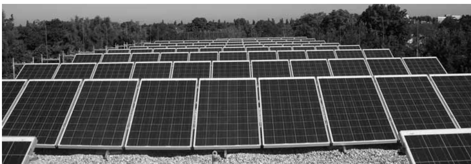
135 Solarmodule auf dem Dach des Forschungsgebäudes
